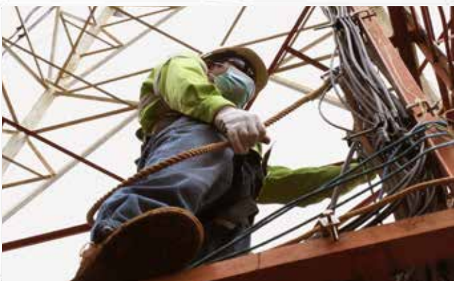
Perawatan menara telekomunikasi yang dilakukan secara berkala oleh tim IT Harita Nickel
